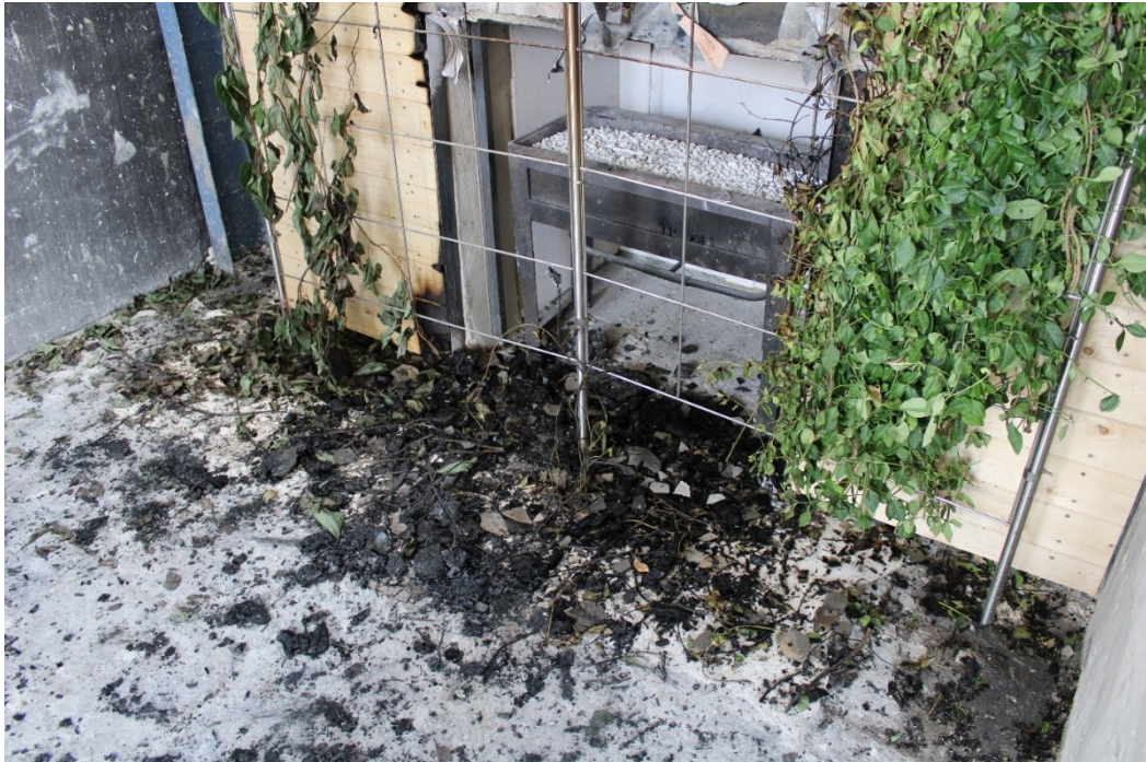
Abbildung 19: Abgefallene Teile verkohlter Fassadenschalung und Begrünung. Die Schädigung der Fassade in der unteren linken Brennkammerecke resultierte aus brennend abgefallenen Holzteilen und dem folgenden Sekundärbrand.
