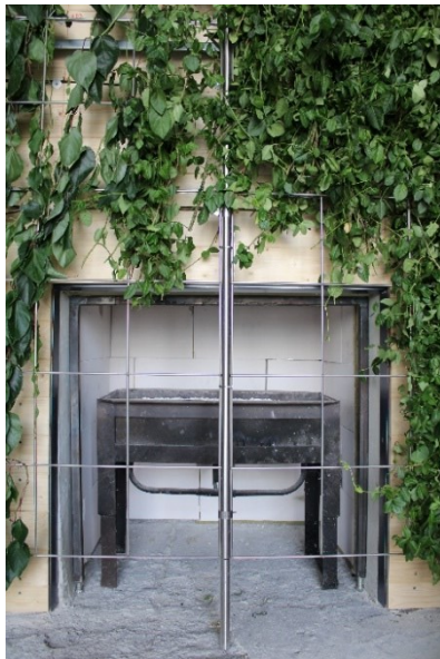
(c) Brennkammer mit Gasbrenner
