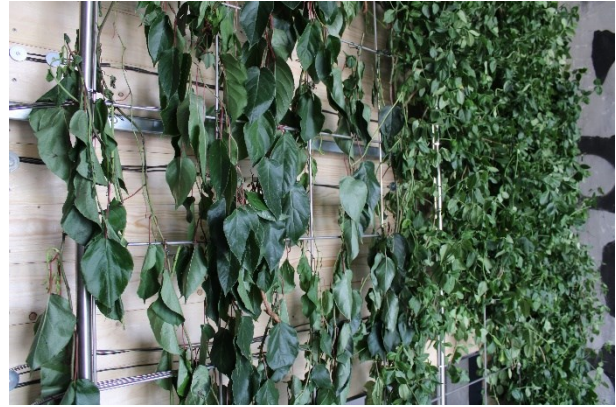
(b) Ansicht der begrünten Holzaußenwandbekleidung auf Höhe der ersten Brandsperre (links Kiwi, rechts Kriechspindel)
