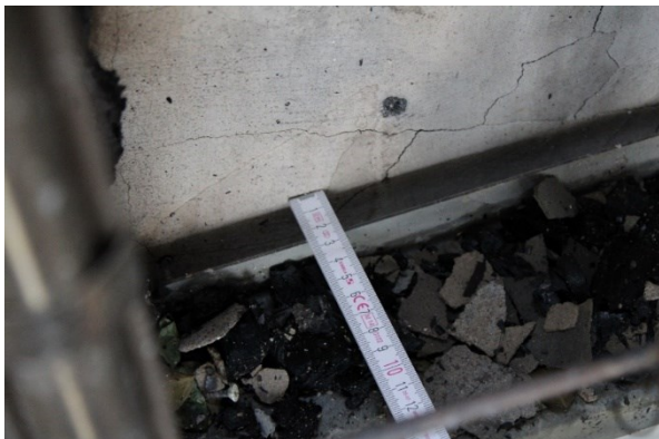
(a) Erste Brandsperre auf 1,75 m Höhe, erkennbar ist der ca. 2,5 cm breite Spalt zwischen Brandsperre (mittig) und Prüfstandwand.
