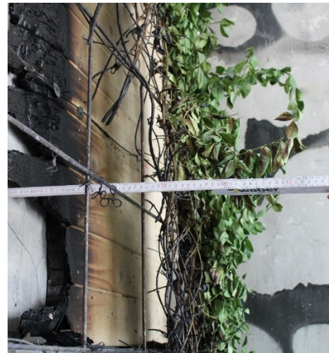
(b) Zwischen Holzaußenwandbekleidung und Rankgitter ausgetrocknete und größtenteils verbrannte Begrünung
